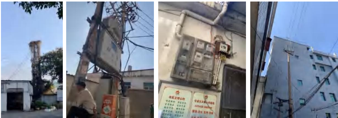
部分电力设施老旧照片
