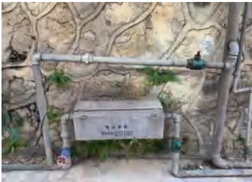
部分老旧给水管照片
