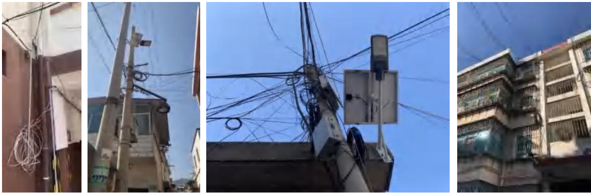
部分电力设施线路杂乱的图片
