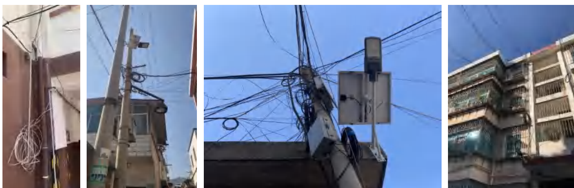
部分电力设施线路杂乱的图片
