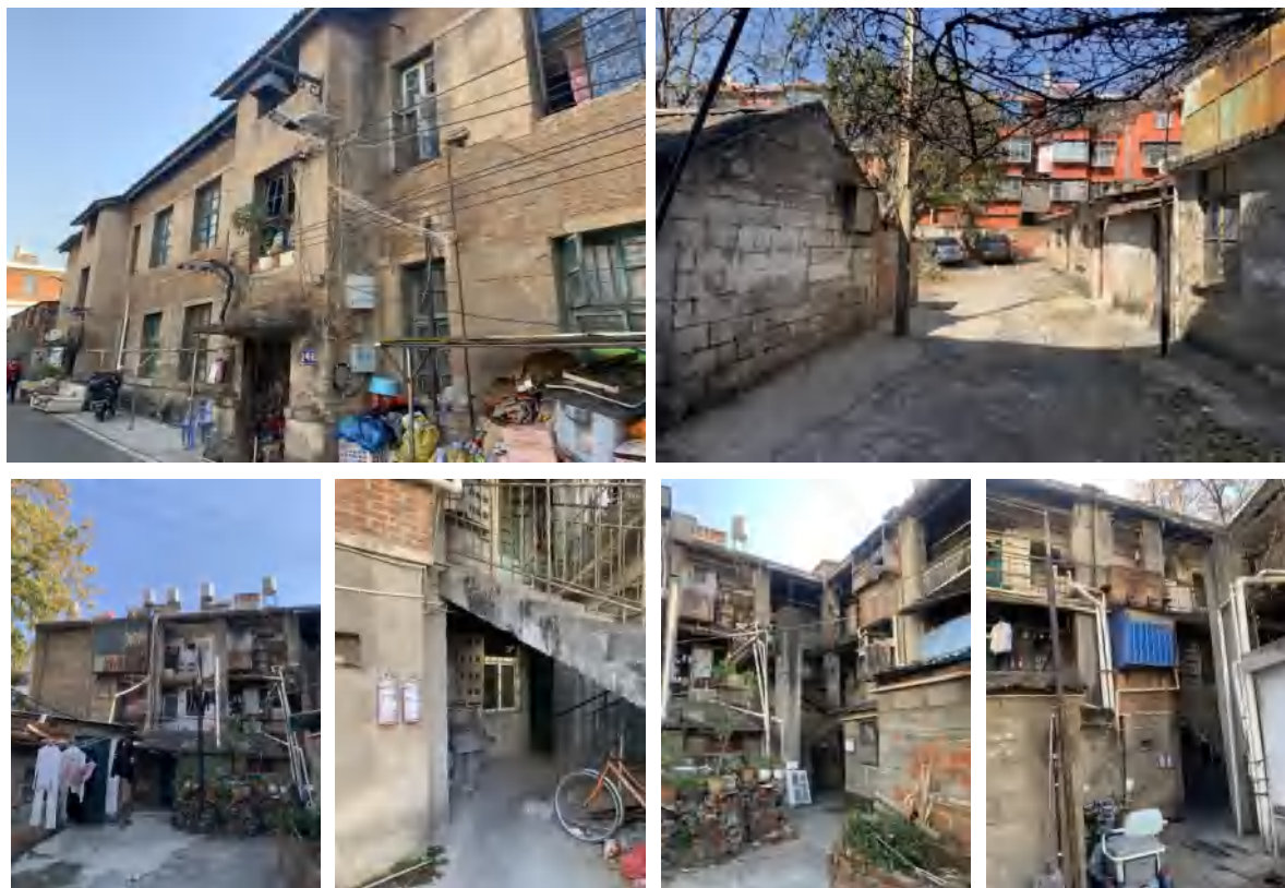
部分需整改C、D级危旧房照片
