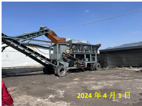
已安装的破碎机
