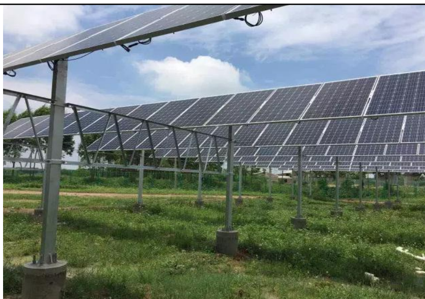
图 2-3 固定式安装运行方式
