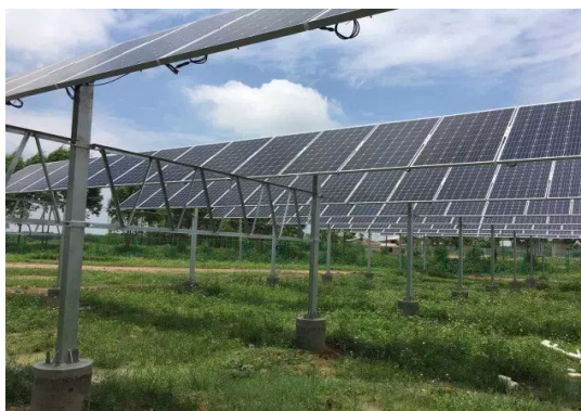
图 2-3 固定式安装运行方式
