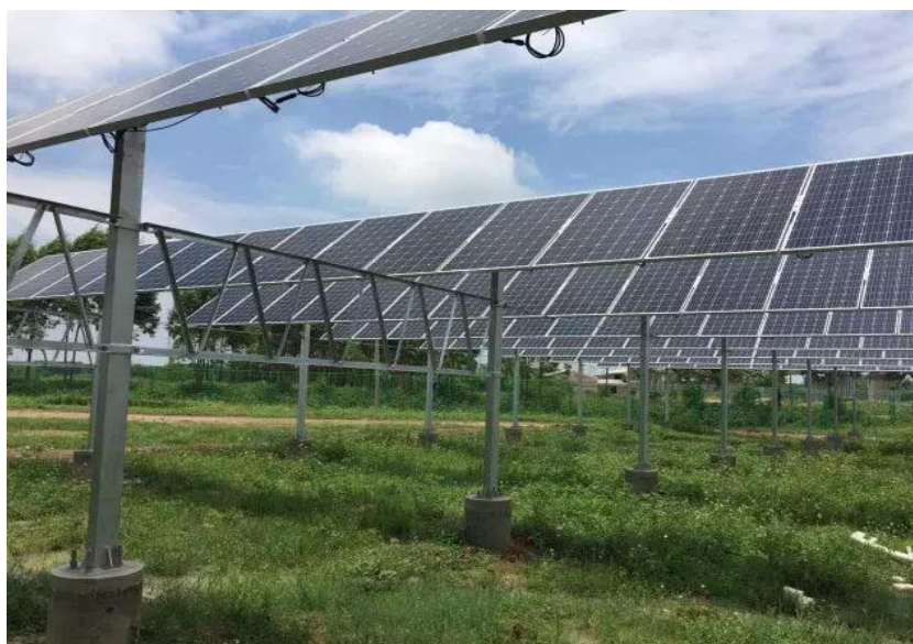
图 2-3 固定式安装运行方式
